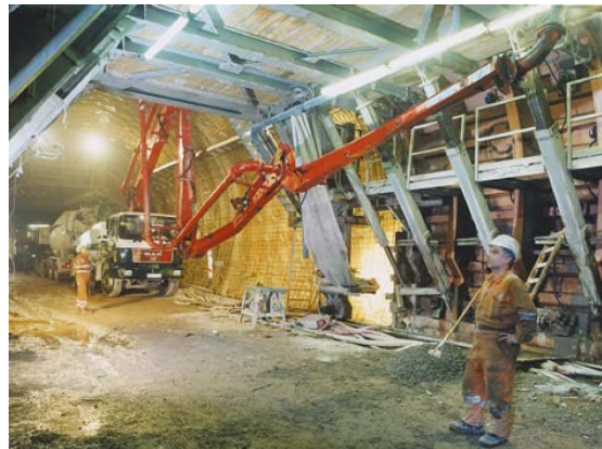
پمپ بتن تونل
