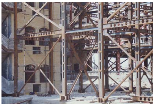
شکل (۲۶): ضعف عضو مهاربند و ابعاد غیر کافی ورقهای اتصال بادبند در یک ساختمان فولادی.
