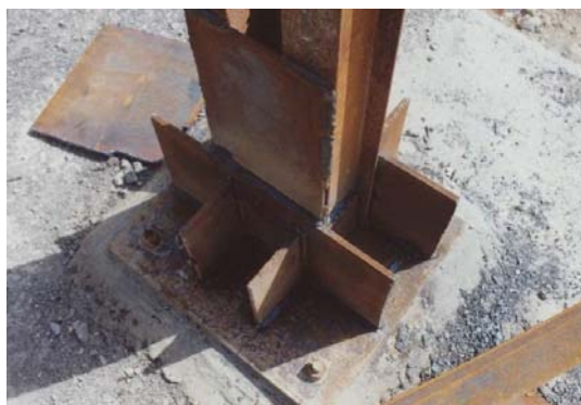
شکل (۲۰): اتصال نامناسب ستون به صفحه ستون در یک ساختمان فولادی که بطور ناخواسته قدری گیرداری بوجود آمده.
