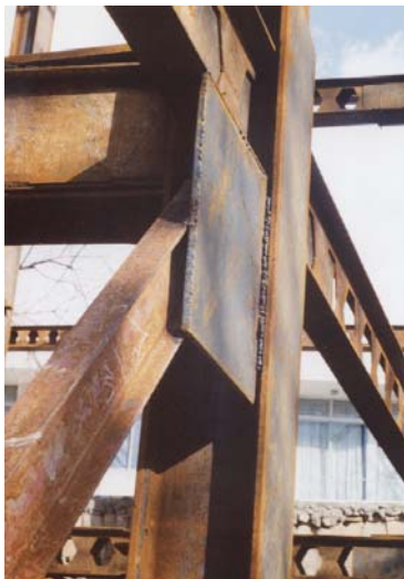
شکل (۲۴): اتصال نامناسب عضو بادبند به صورت خارج از مرکز با نصب ورق اتصال در لبه بال ستون و تیر.
