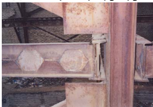
شکل (۲۳): اتصال نامناسب مهاربند در یک قاب با اتصالات خورجینی که تنها به ستون متصل شده است.
