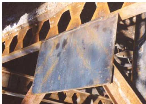
شکل (۲۵): اتصال نامناسب اعضای بادبندی (به شکل هشت یا شورن) به صورت خارج از مرکز با نصب ورق اتصال در لبه بال تیر. در ضمن جان تیر لانه زنبوری نیز تقویت نشده است.
