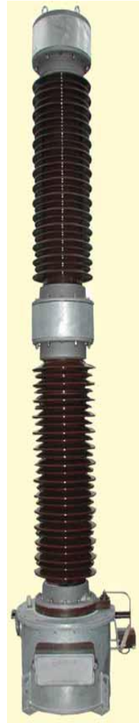
ترانس ولتاژ خازنی
