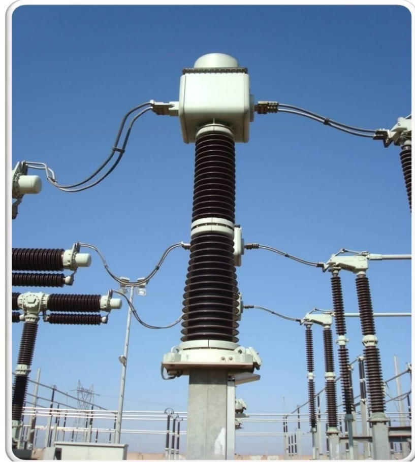
ترانسفورماتور جریان (CT) {Curent transformer}
